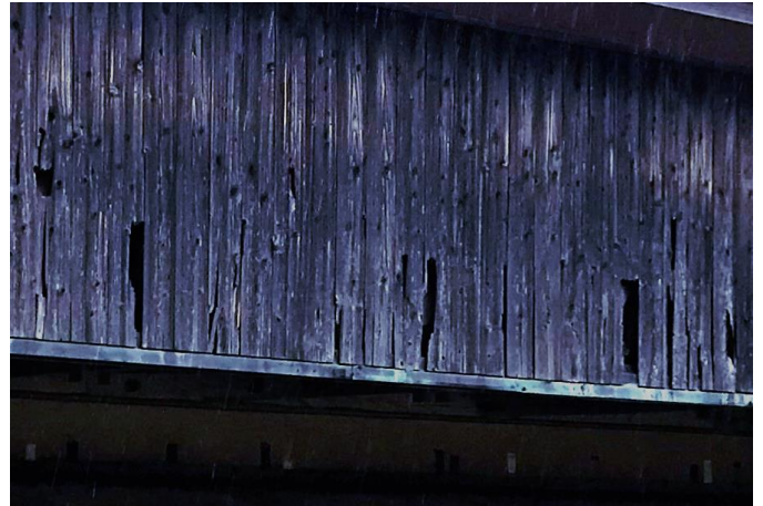
② 痛んで穴の空いた壁
